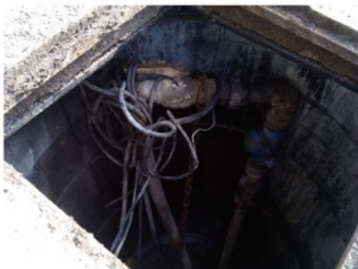
ČERPACÍ STANICE ČS8 - PO POVODNI UVNITŘ
